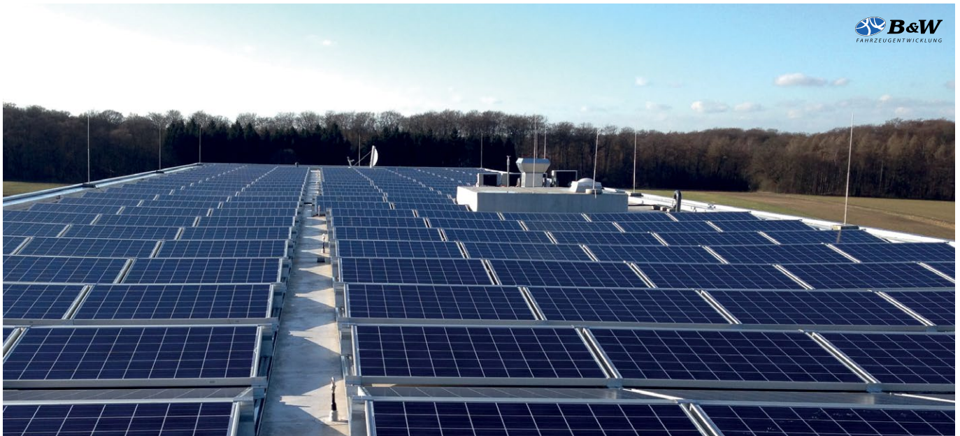
100 kWp Q.FLAT PV-Anlage auf dem Dach des Kompetenzzentrums der B&W Fahrzeugentwicklung GmbH
